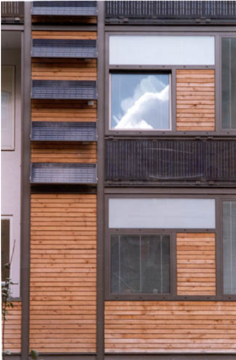
Solceller på gavl på etagebyggeri – kan accepteres
